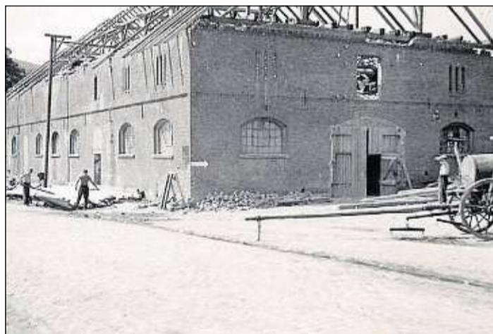
Auf der Baustelle: Im Jahr 1937 wurde die Scheune in Bursfelde auf dem Klostergut gebaut.
